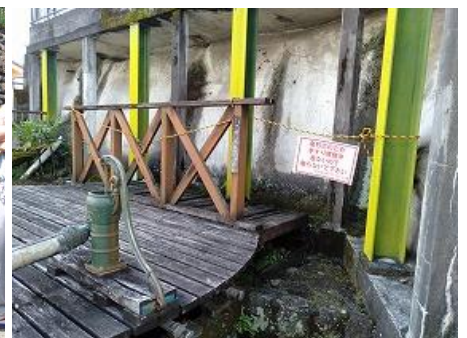
老朽化した井戸蓋・デッキ
