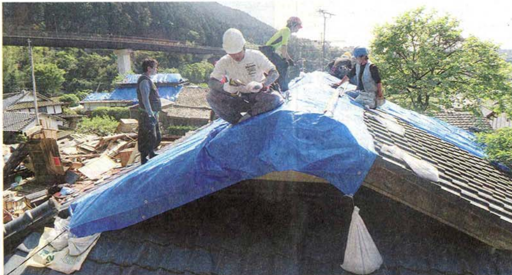
被災した家屋の屋根を補修する職人(熊本県大津町で(グラウンドワーク三島提供))
