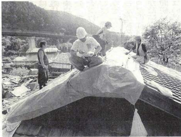
熊本地震被災地で屋根にシートを張る職人＝熊本県大津町で(グラウンドワーク三島提供)
