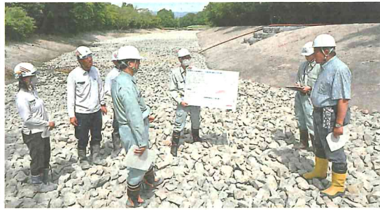
川底を歩き、工事の進捗を確認する渡辺専務理事(右端)ら 三島、沼津市境の松毛川
