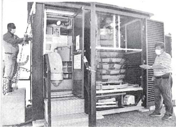
串間市都井岬の小松ヶ丘広場に設置されたバイオトイレ
